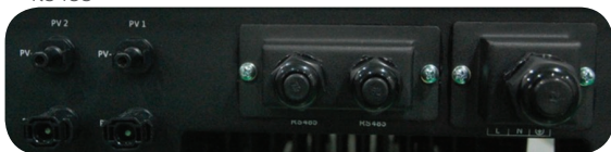
Figura 5: Terminais do Inversor Fotovoltaico (5kW)
